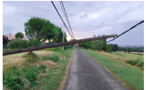
Poteau bois cassé réseau basse tension
